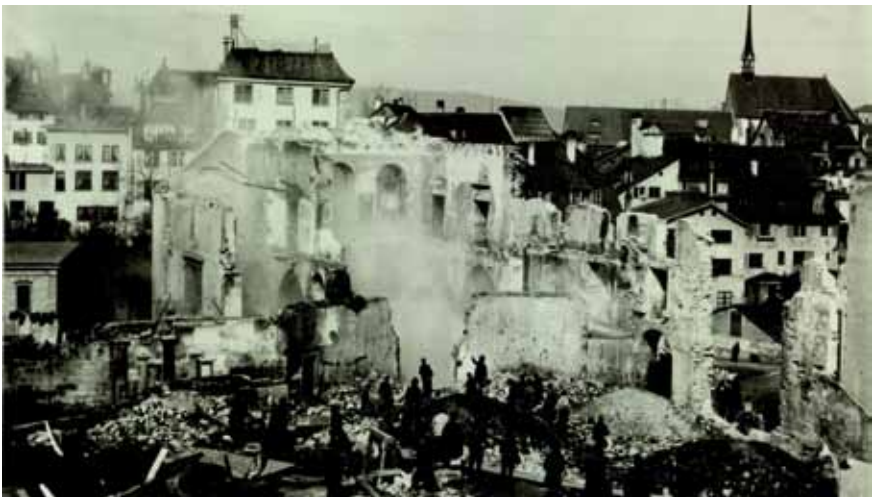
Abbrucharbeiten am ausgebrannten Zürcher Aktientheater am 12. März 1890. Foto Brei- tinger, Baugeschichtliches Archiv Zürich
