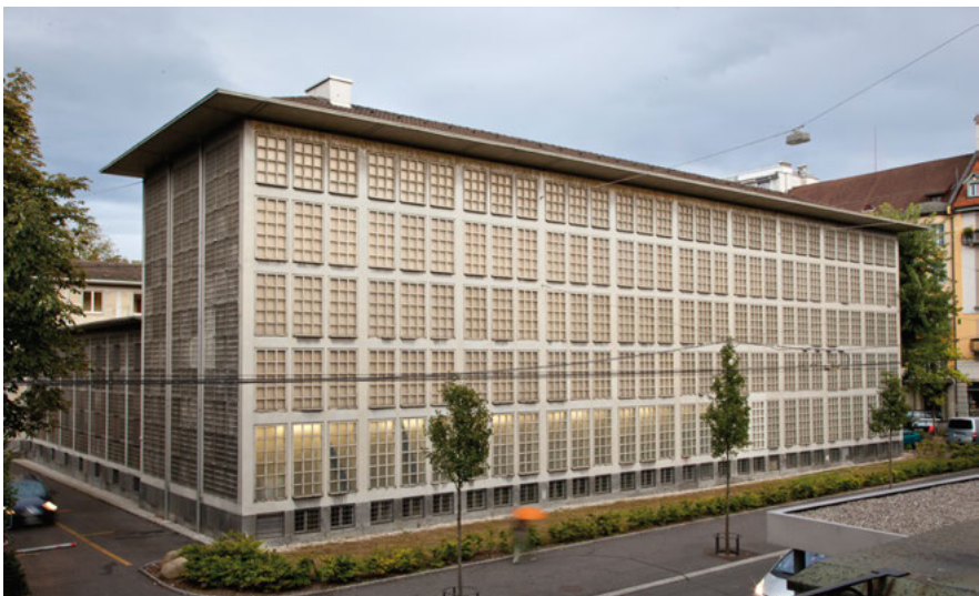
Abb. 3: ZHB, Magazin an der Hirschmattstrasse. Die teils schadhaften, abgebrochenen Simsse sind deutlich sichtbar. (© Ulrich Niederer, ZHB Luzern)
