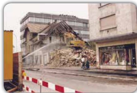
Die «Harmonie» ist gründlich zerstört (1985).
